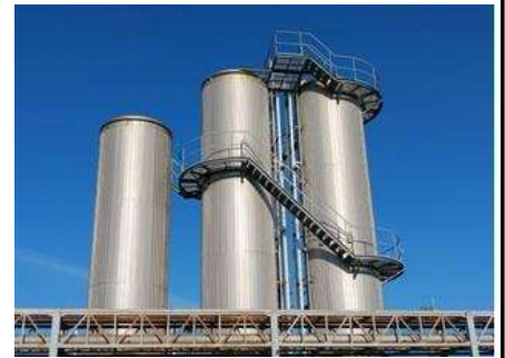
【酸生成槽/反応槽(EGSB処理方式)】
